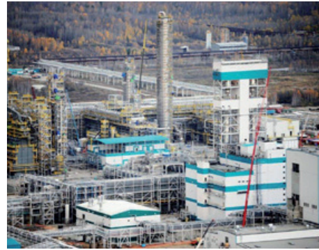
Установка производства полипропилена. Объекты ОЗХ и энергосредств (2012)
