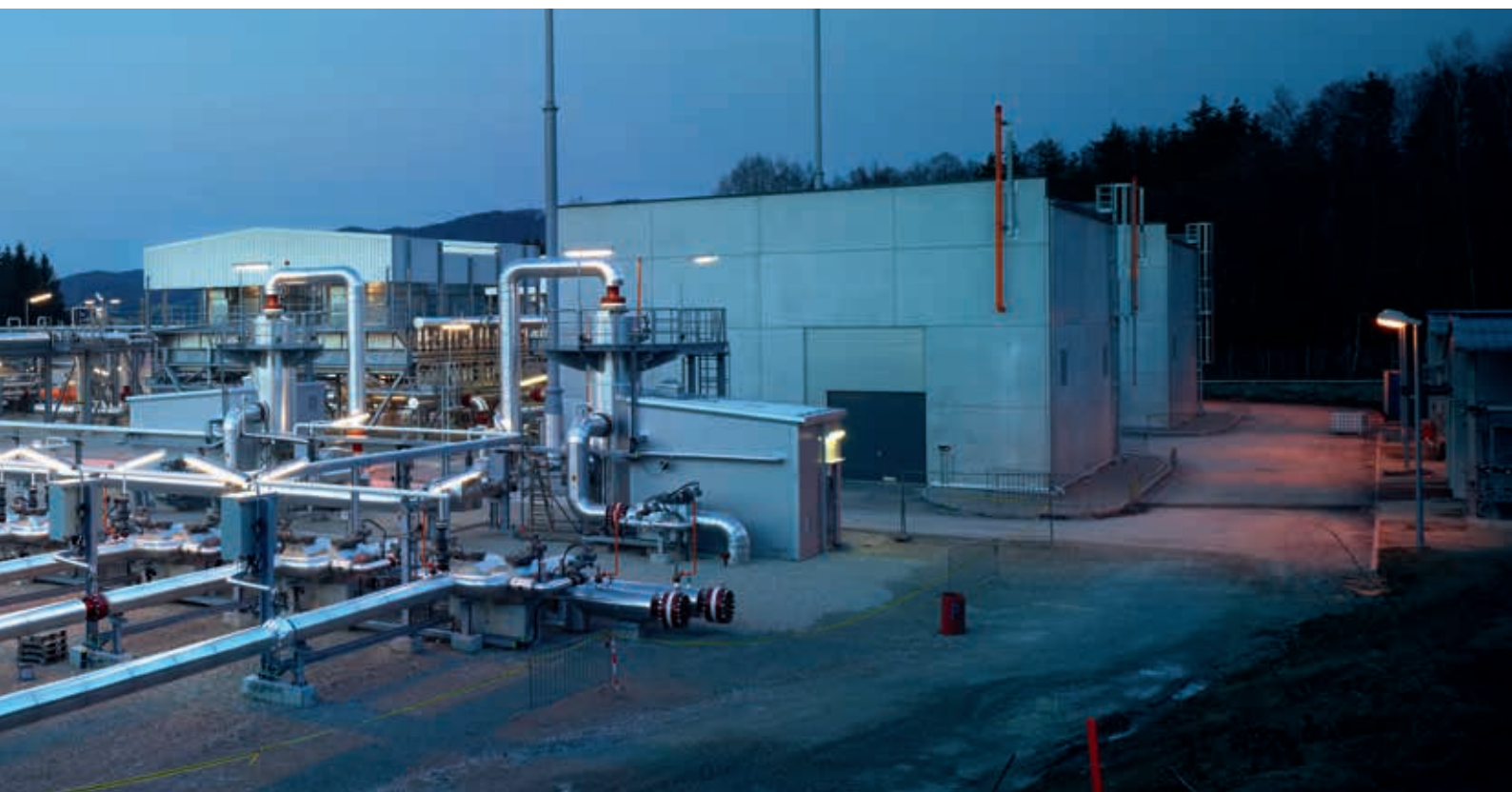
Пористый газовый коллектор в Нуссдорфе
