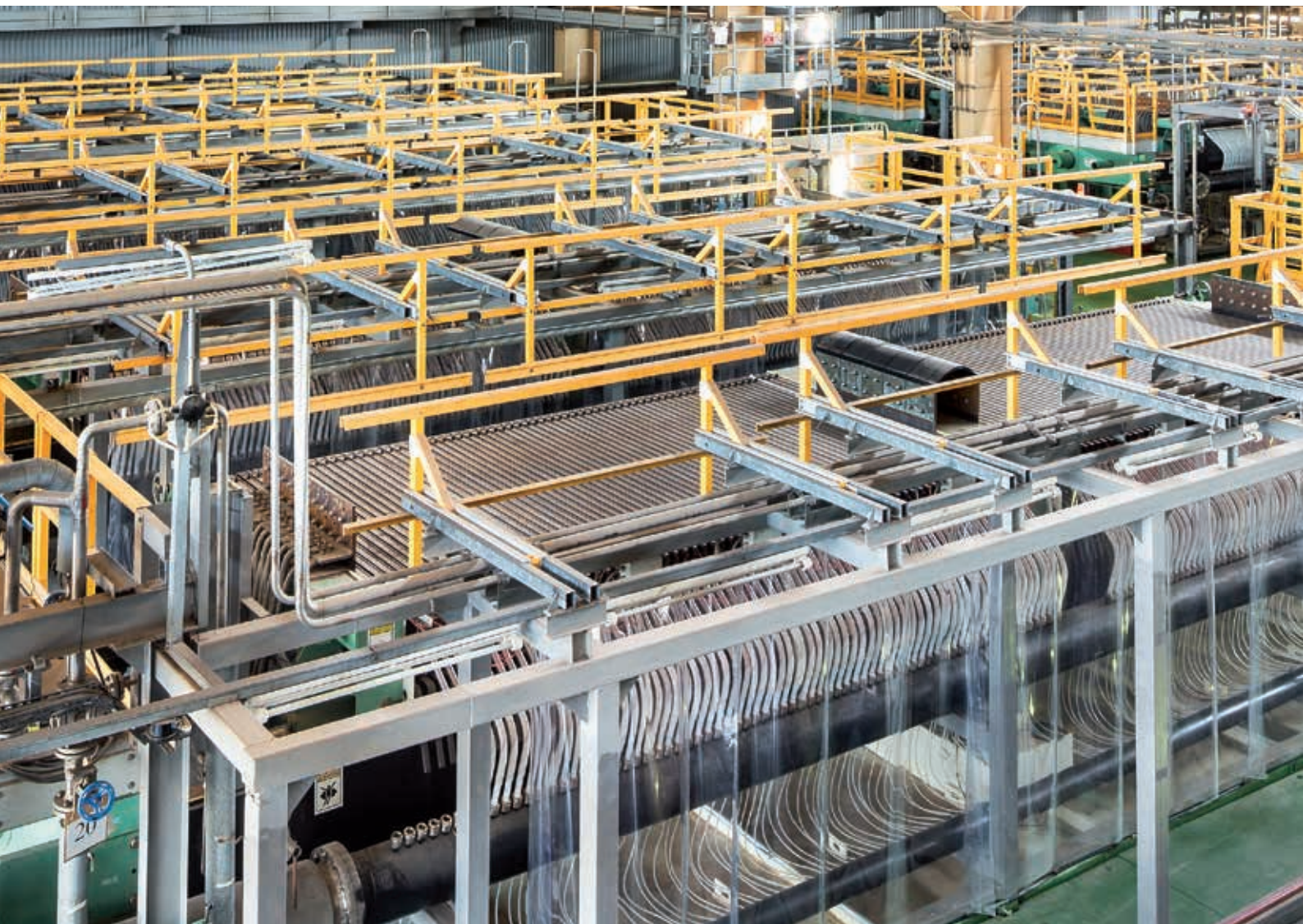
Цех электролиза хлорно-щелочного производства
